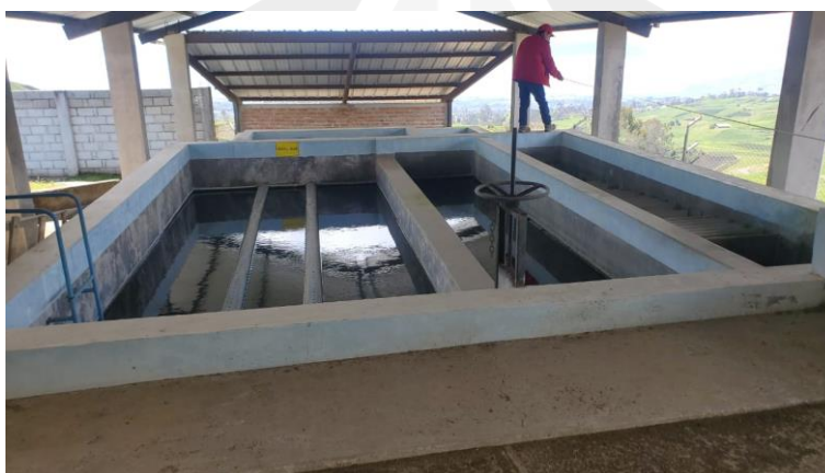
Planta de tratamiento de Sta. Lucía Bellavista – Módulos de filtración
