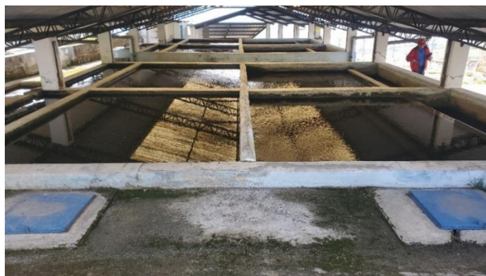
Planta de tratamiento de Sta. Lucía Bellavista – Módulos de sedimentación
